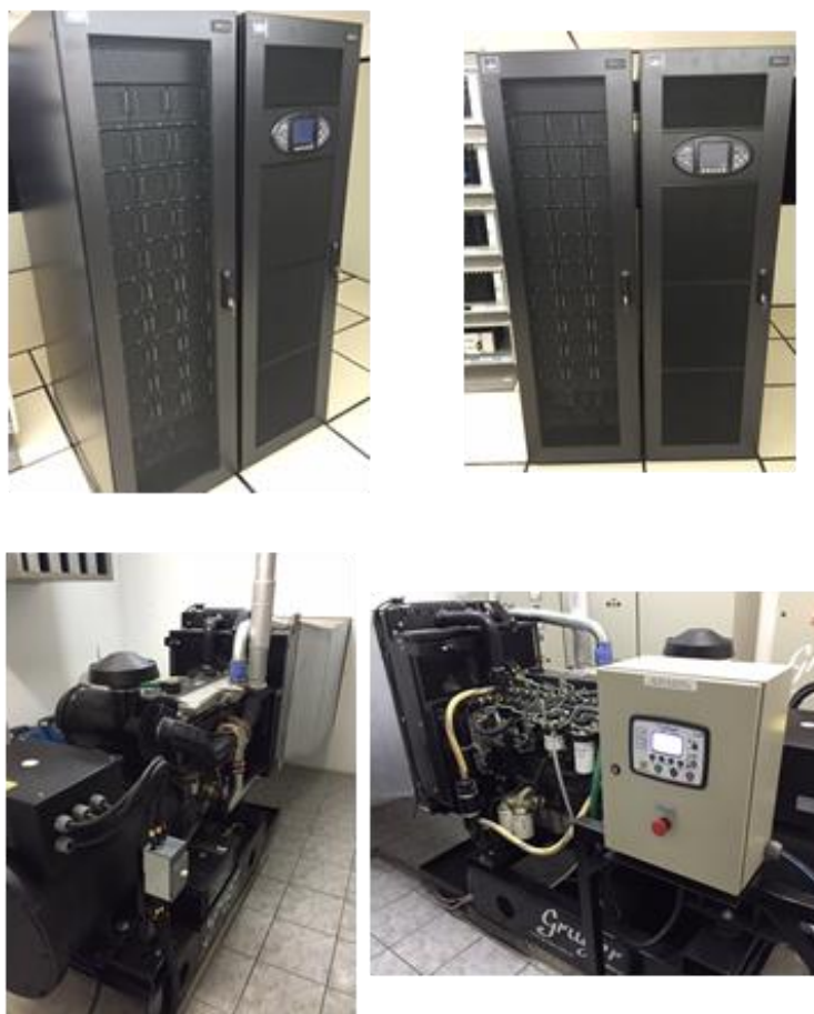
Figura 30 – Novos no-breaks e grupo gerador do datacenter UFSC/PoP-SC
