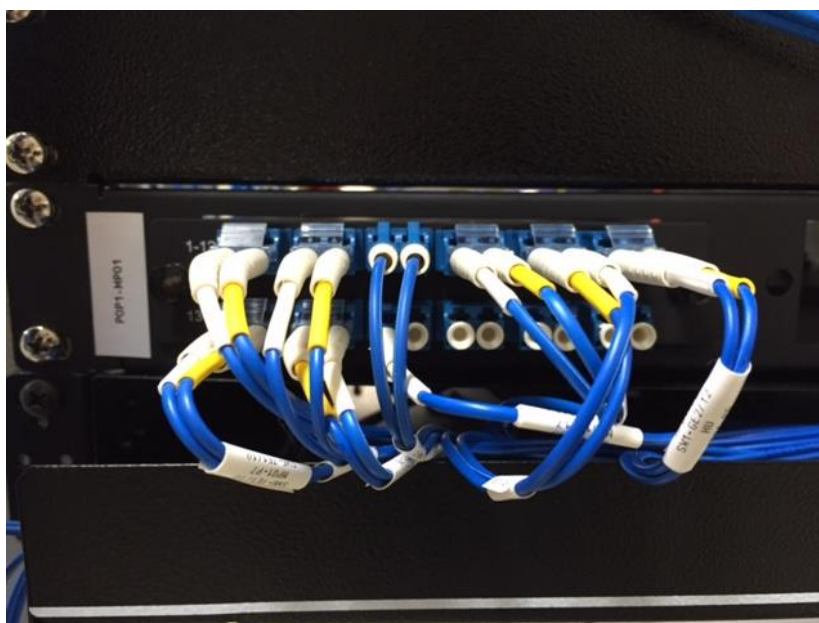
Figura 29 - No detalhe foto do K7 MPO em um dos racks
