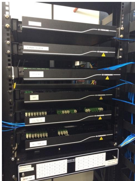
Figura 34 - Rack Operadoras 2 - DIOs
