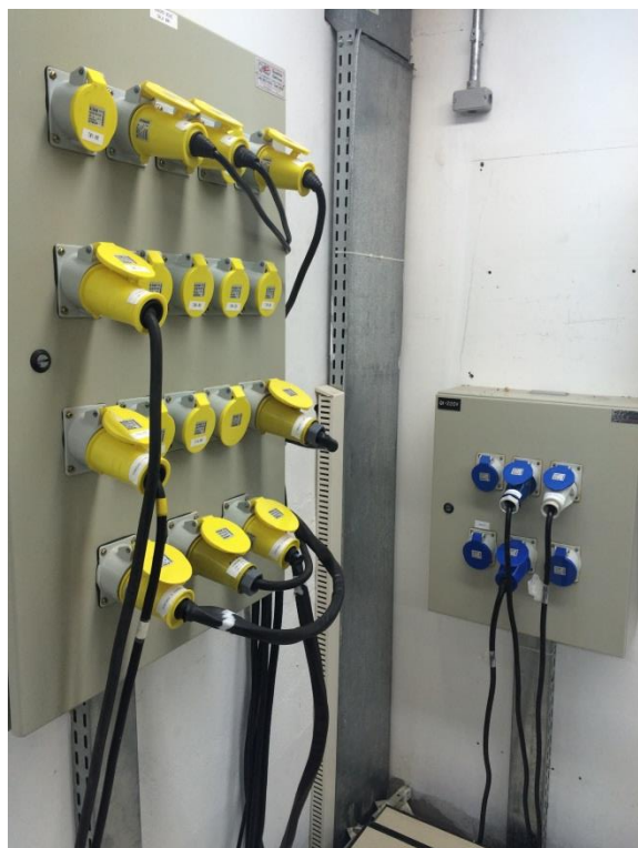
Figura 23 – UFSC- Alguns quadros elétricos
