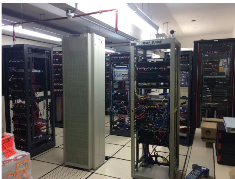
Figura 27 - Visão Geral datacenter PoP-SC
