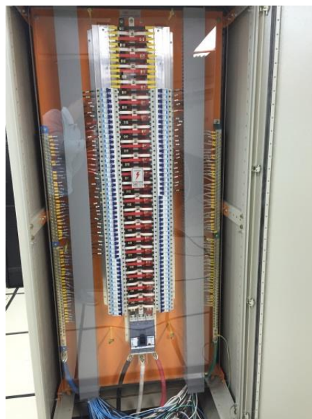
Figura 26 - UFSC - novo quadro elétrico (Abril/2016)
