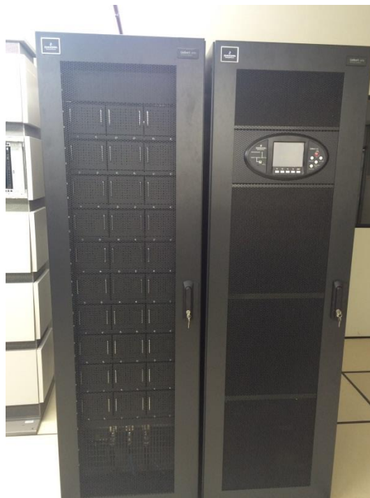
Figura 24 – UFSC - Nobreak Emerson (instalado em 150Kva Abril/2016)
