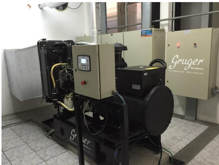
Figura 25 – UFSC Gerador 160 KVA (Instalado em Abril/2016)
