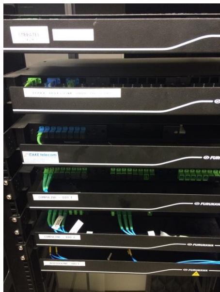
Figura 33 - Rack Operadoras 1 - DIOs
