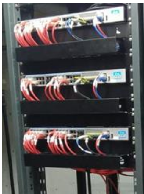
Figura 47 - Novos agregadores WAN implantado no rack 7.0, em detalhe(Figura 45) (2020)
