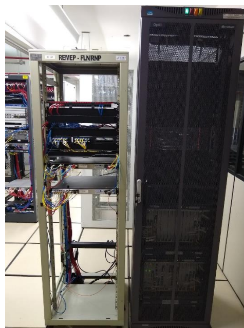
Figura 35 - Rack da REMEP-FLN & DWDM Eletrosul
