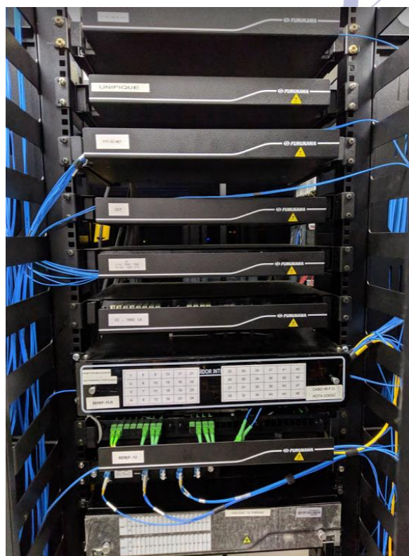
Figura 44 - Rack Operadoras 2 - DIOs
