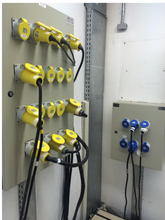
Figura 30 – UFSC- Alguns quadros elétricos
