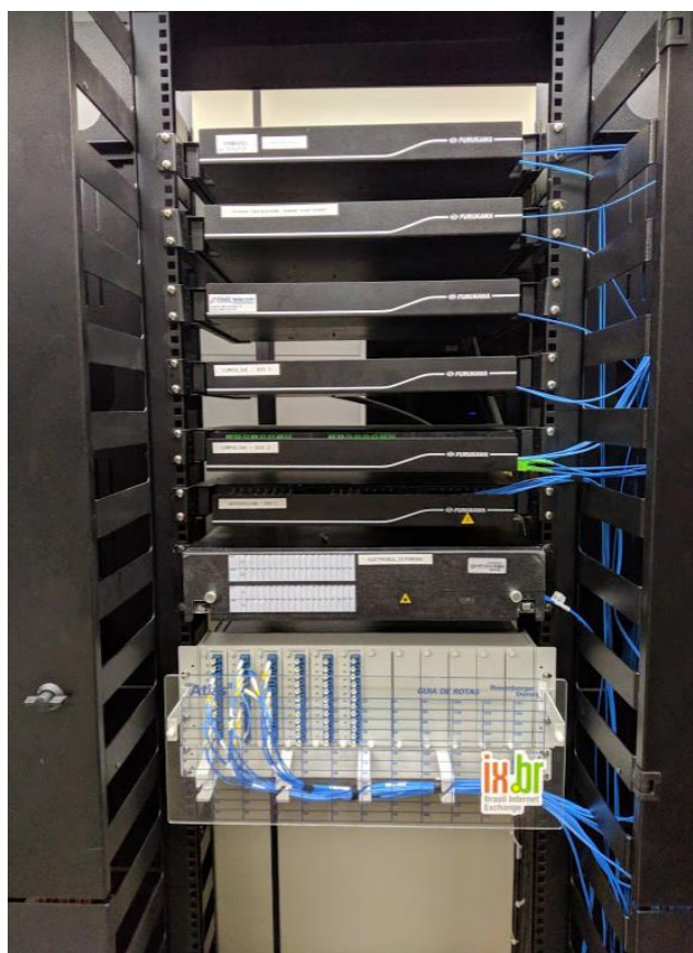
Figura 43 - Rack Operadoras 1 - DIOs
