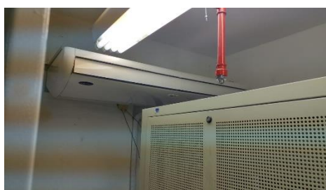
Figura 40 – Ar condicionado de contorto 1 - RNP
