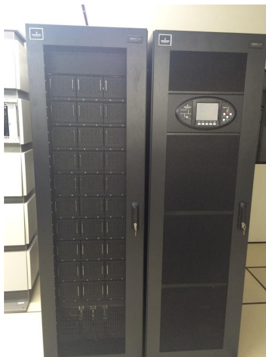
Figura 31 – UFSC - Nobreak Emerson (instalado em 150Kva Abril/2016)
