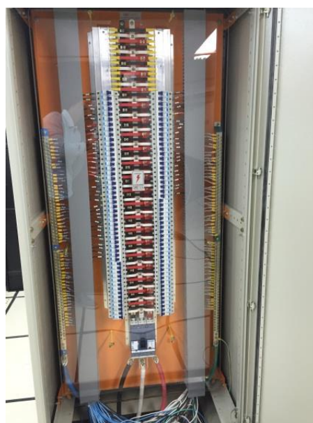
Figura 33 - UFSC - novo quadro elétrico (Abril/2016)
