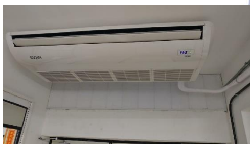
Figura 39 - Ar condicionado de contorto 3 instalado pela abrigo em 2021
