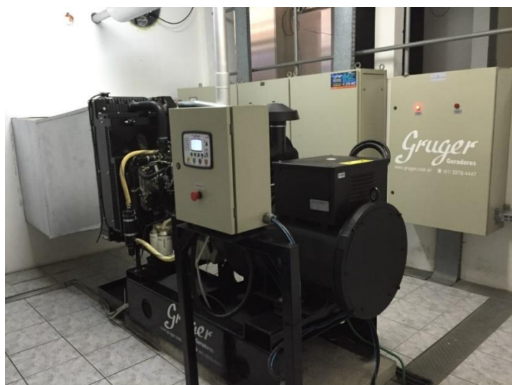
Figura 32 – UFSC Gerador 160 KVA (Instalado em Abril/2016)
